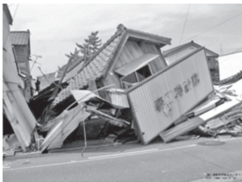
倒壊した家屋(新潟県中越沖地震) 写真提供：(財)消防科学総合センター
