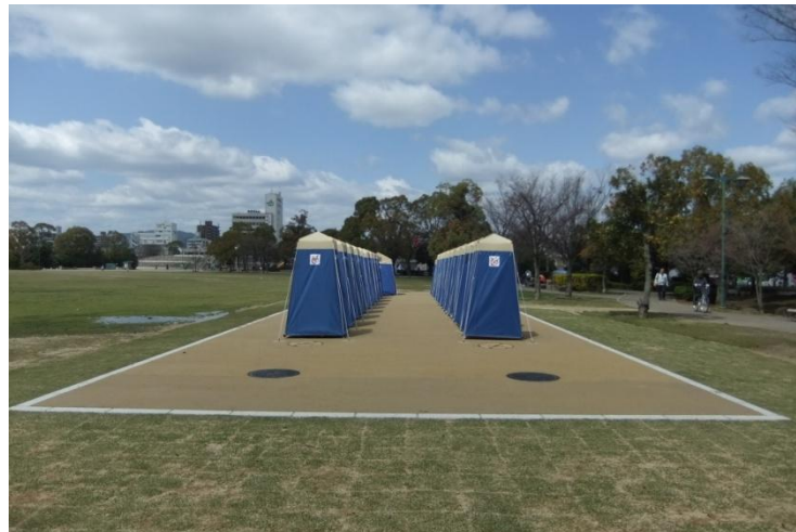
災害対策用マンホールトイレ（福山市緑町）
