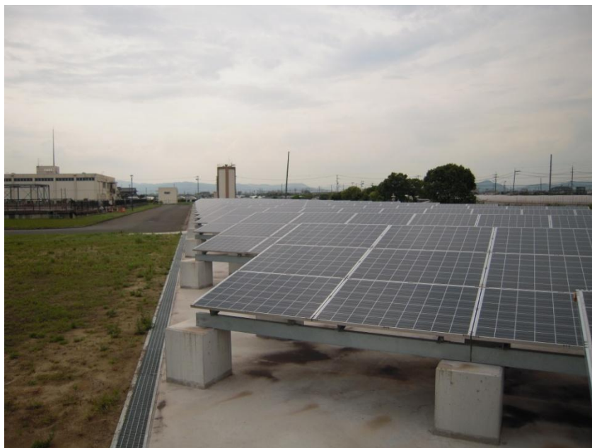
箕島浄水場 太陽光発電システム（福山市箕島町）
