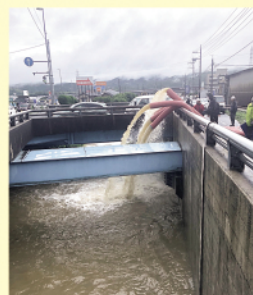
仮設ポンプ(吐き口)
