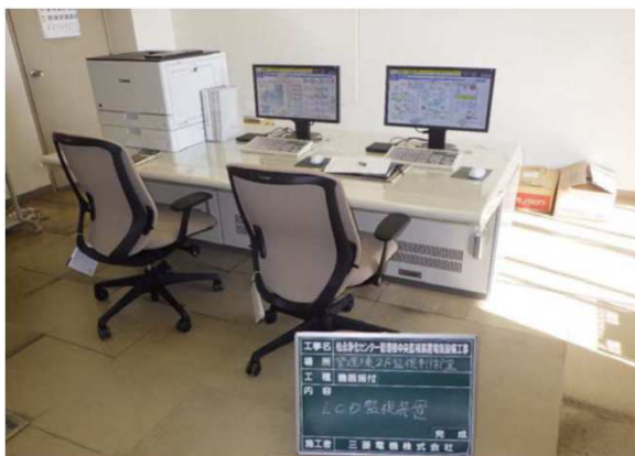
松永浄化センター管理棟中央監視装置電気設備工事
