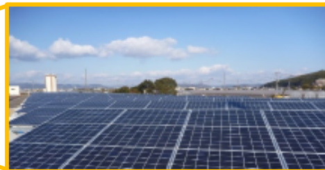
設置されている太陽光パネル
