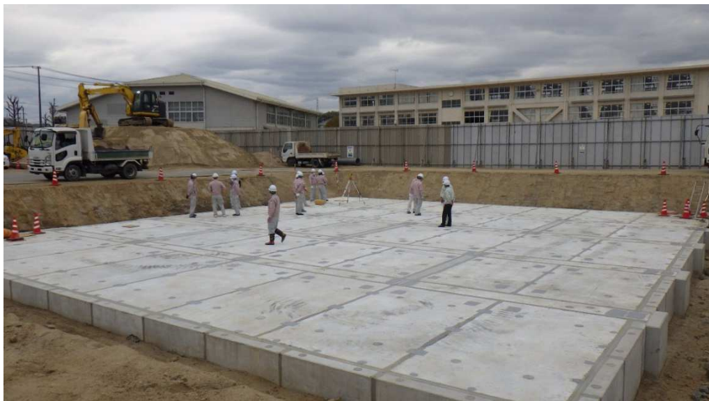
「機織排水区雨水貯留施設」
