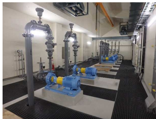
「建屋内のポンプ設備」
