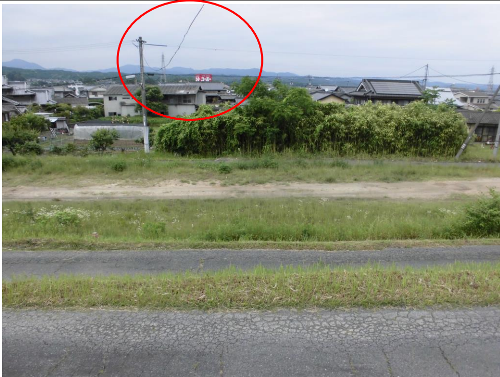
電線 南側から
