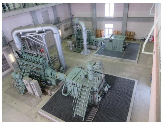
●奥側が増設されたポンプ
