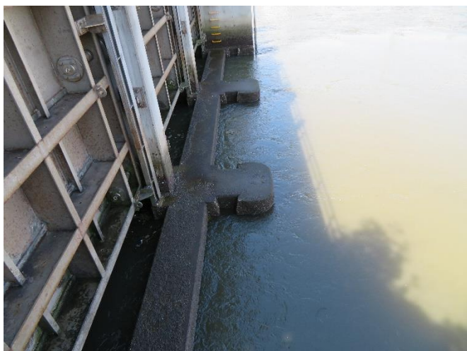
●福山港へ排水される様子
