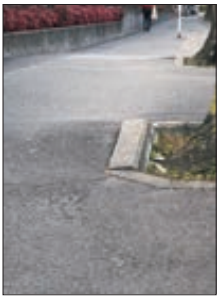
大径木が持ち上げた舗装
