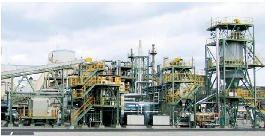
下水污泥燃料化施設(公益財団法人広島県下水道公社 提供)
