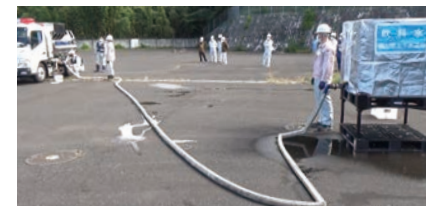
給水車から仮設水槽へ
