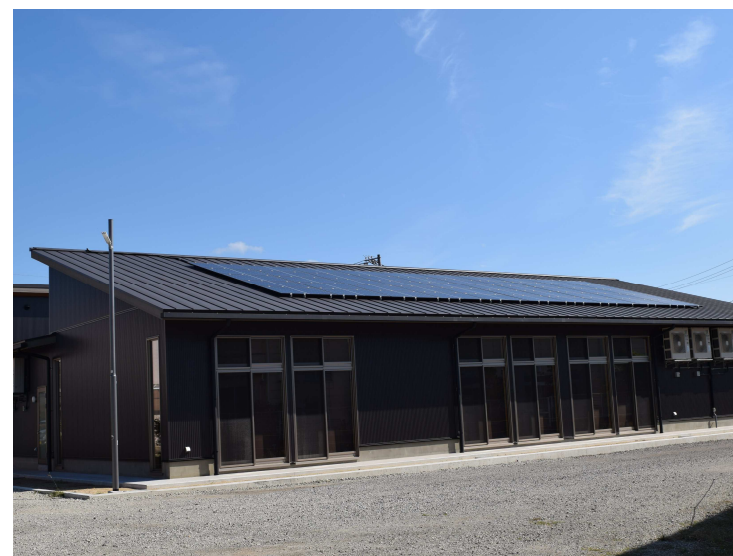
PPAモデルにより導入した太陽光発電設備
