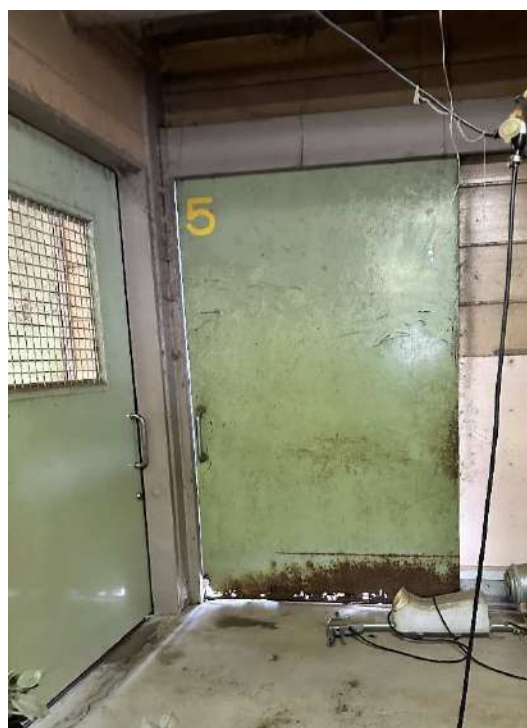
動物の尿による腐食
