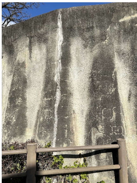
動物囲い壁面の亀裂
