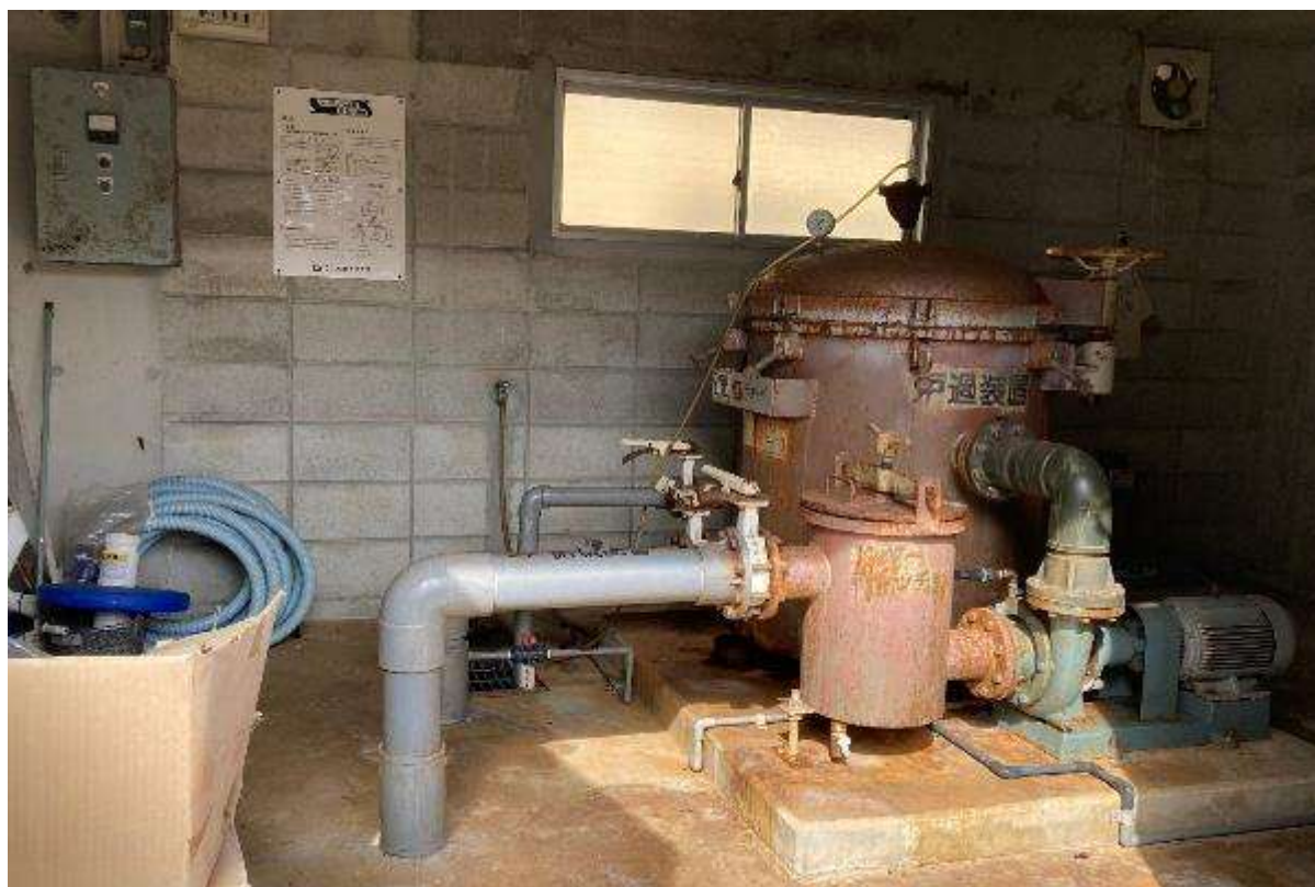
＜プール付属棟機械室 ろ過機（残置）＞
