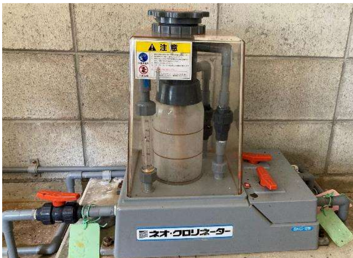
＜プール付属棟機械室 塩素供給システム（残置）＞
