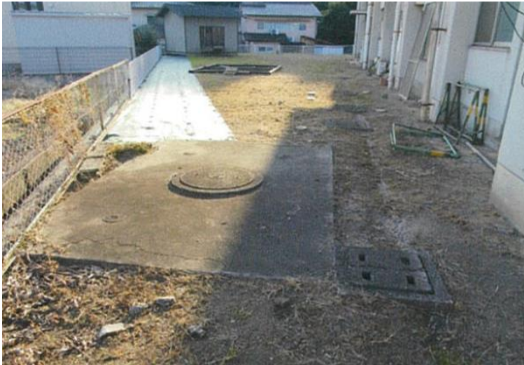
地下オイルタンク
