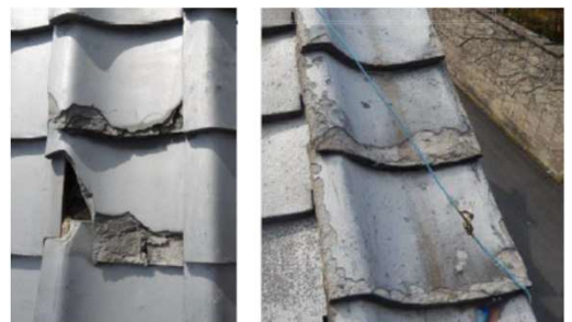
瓦が著しく破損している例
