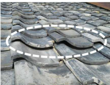
瓦に浮き上がりが生じている
