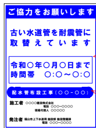
新しい路上工事看板（工事中表示板）
