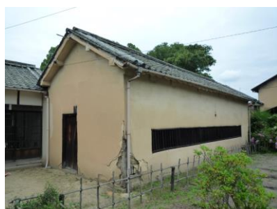
寮舎全景（壁面の崩落）
