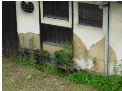
壁面（漆喰）の剥離
