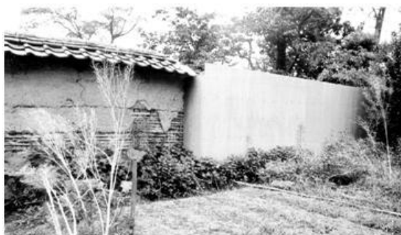
土塀破損状況
