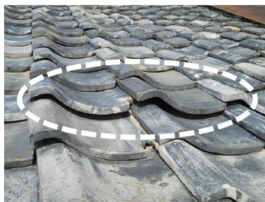
瓦に浮き上がりが生じている
