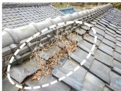
瓦がずれ下がり、葺き土に植物がみられる
