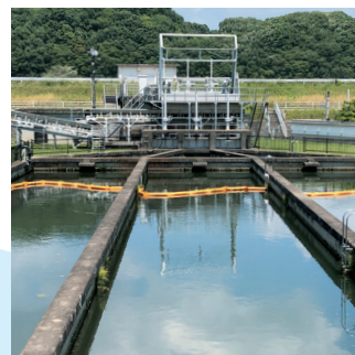
ちん さ ち 沈砂池
