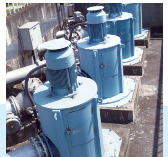
どうすい 導水ポンプ
