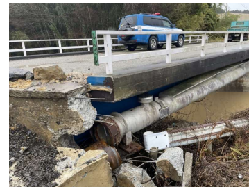
▲橋の下に設置された水道管の損傷 （抜け落ち） 出典：名古屋市上下水道局
