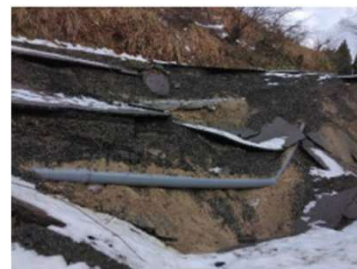
▲浄水場から配水池へ向かう水道管の 破損・露出 出典：輪島市
