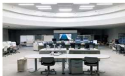
▲中央管理センター（中津原浄水場）
