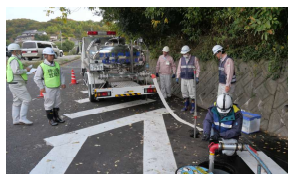
▲緊急時連絡管
