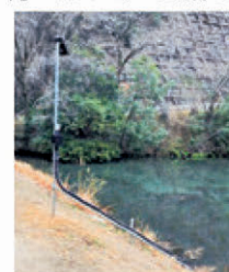
水呑町の新池に設置されている、ため池遠隔監視システム
