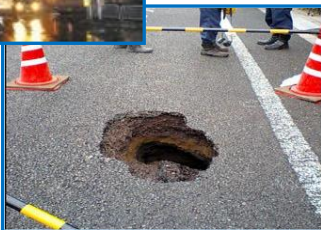
《右図》 下水道管の破損による道路陥没 ※出典：朝日新聞
