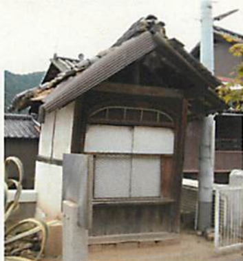
【修理前…建物が傾き、屋根瓦が落下】
