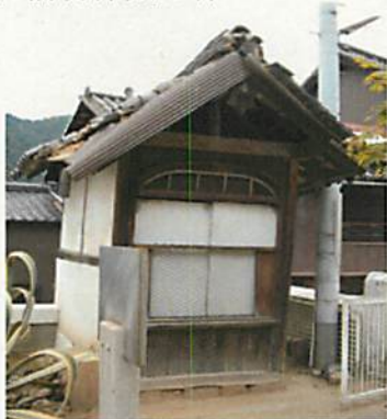
【修理前…建物が傾き、屋根瓦が落下】
