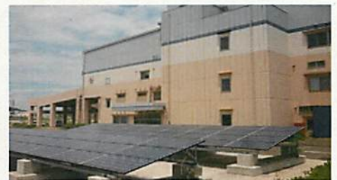
【ごみ固形燃料工場の太陽光発電設備】
