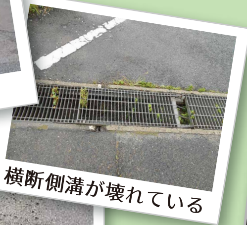
柵が壊れている
