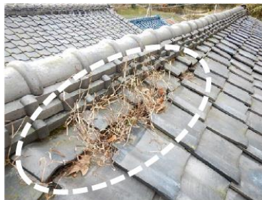
瓦がずれ下がり、葺き土に植物がみられる
