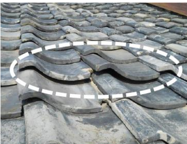
瓦に浮き上がりが生じている
